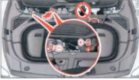
الصورة 156 سطح أمامي: وصلات بكوابل الشحن أو كوابل التشغيل
